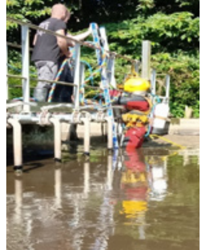
Intervention de plongeur dans le bassin d'aération de Lanvollon pour le curage de celui-ci.
